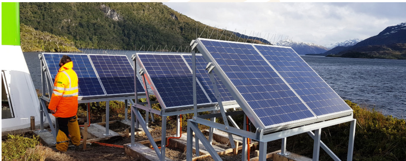
Panneaux solaires dans une installation d'aides à la navigation
